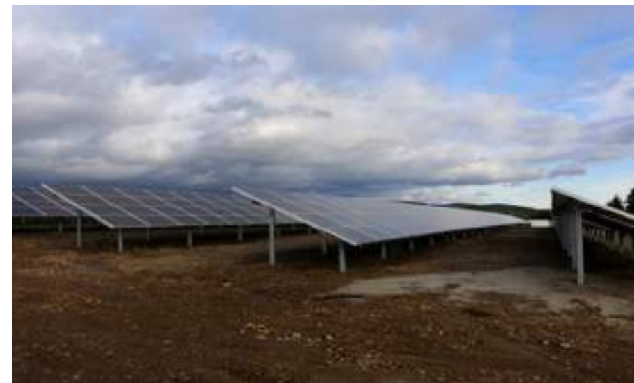
Figure 261 : Exemple d'espace non empierré entre tables – Q ENERGY France
