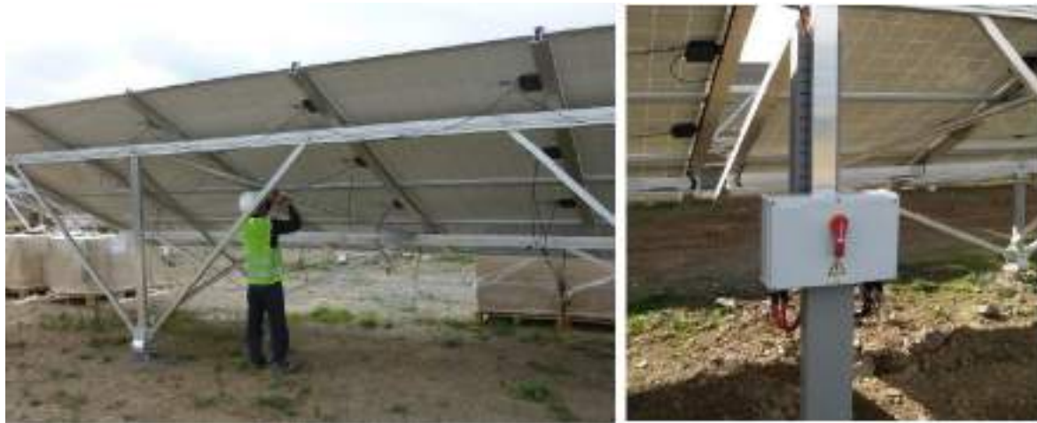
Figure 268 : Câblage des panneaux (à gauche) ; Boîtier de raccordement (à droite) – Q ENERGY France
