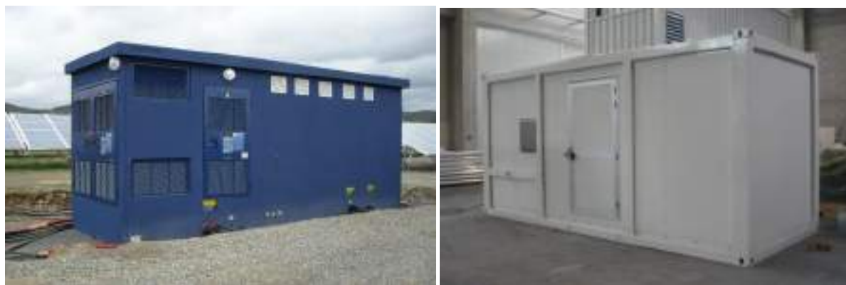
Figure 255 : Exemple d'onduleurs et transformateurs installés dans des postes béton et containers
