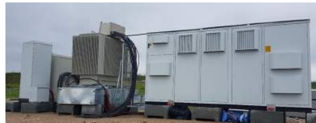
Figure 257 : Exemple d'onduleurs et transformateur installés à l'extérieur
