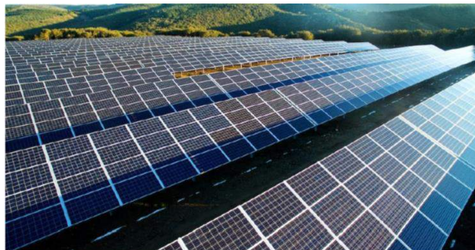
Figure 250 : Exemple de structure fixe (source : Q ENERGY France)
